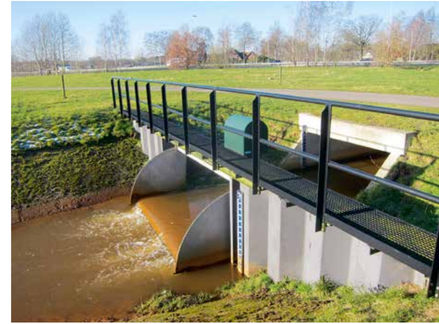
Verdeelwerk van de Klaarbeek. Over de neergelaten klep van de stuw moet eigenlijk nog een rubberen slab komen, zodat bodemvissen er stroomopwaarts overheen kunnen. foto Michiel Hegener
